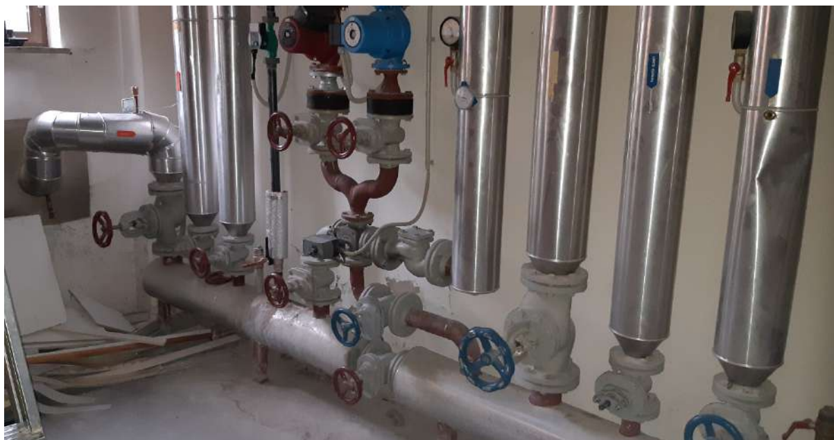
Slika 2: Posnetek razdelilnika ogrevalne vode v toplotni postaji
